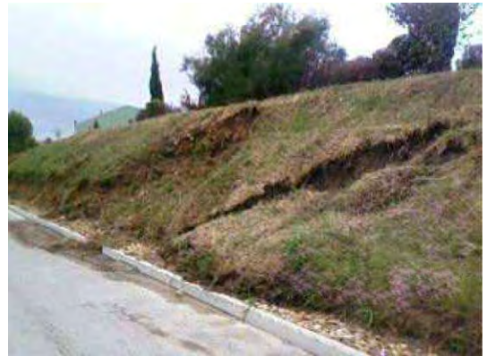
... pouvant occasionner des coulées boueuses et détériorer les talus.
